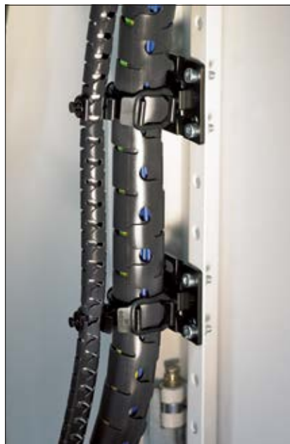
Protecția și fixarea cablurilor cu furtunul Helawrap și accesoriile acestuia, de exemplu în panouri.
