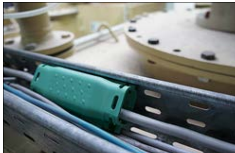
Gel-Kabelgarnitur Relifix V als Kabelverbindung.
